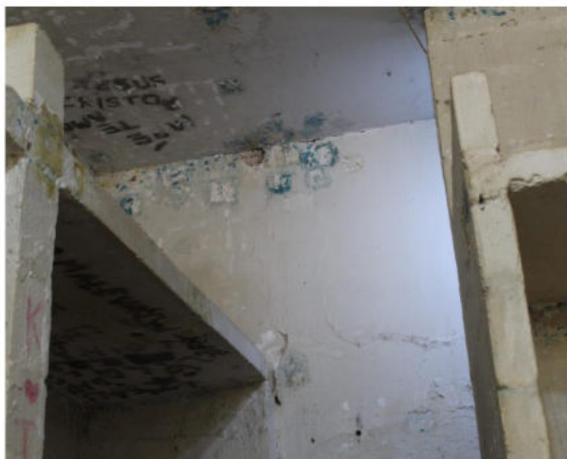
Foto da parte superior de uma das celas com infiltrações e mofo
