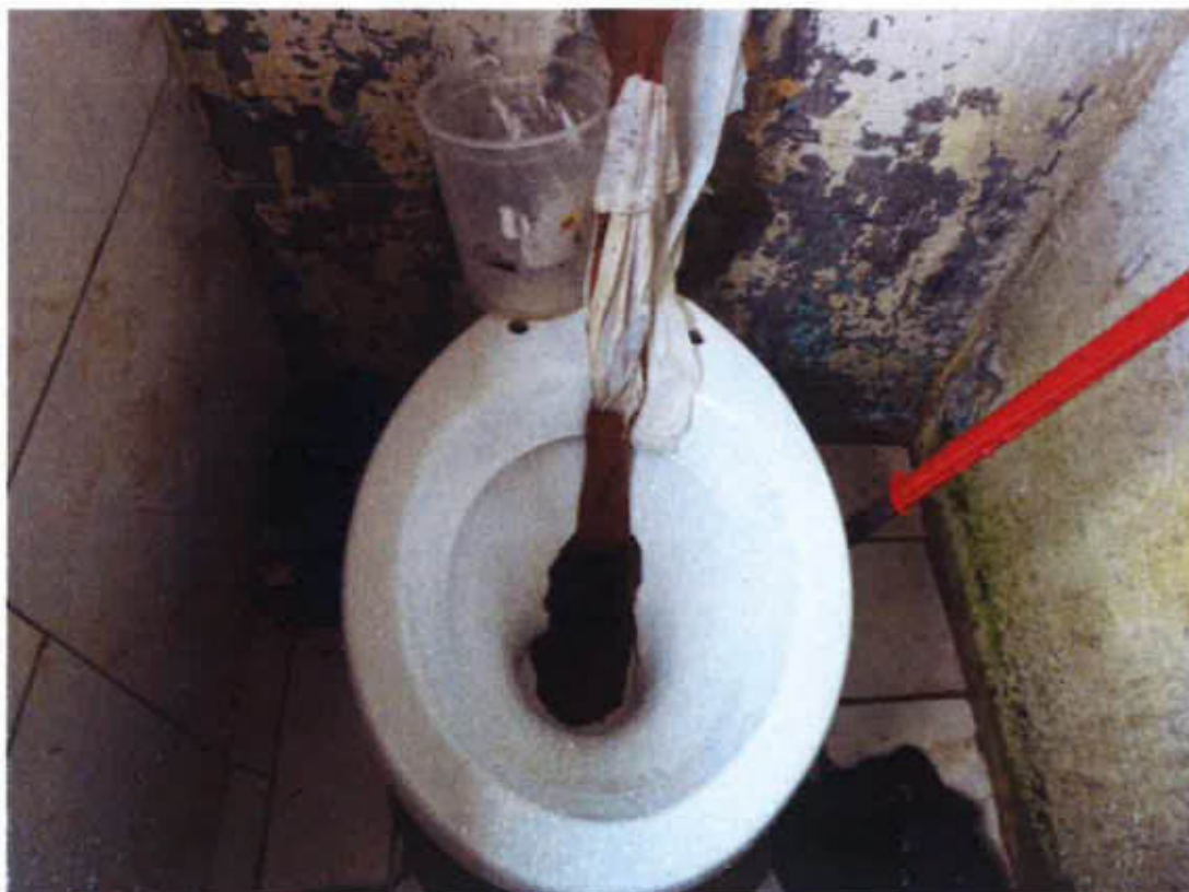
Detalhe para vaso sanitário danificado no interior da cela do setor seguro
