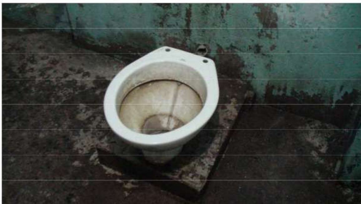
Vaso sanitário quebrado, para uso pelas visitantes
