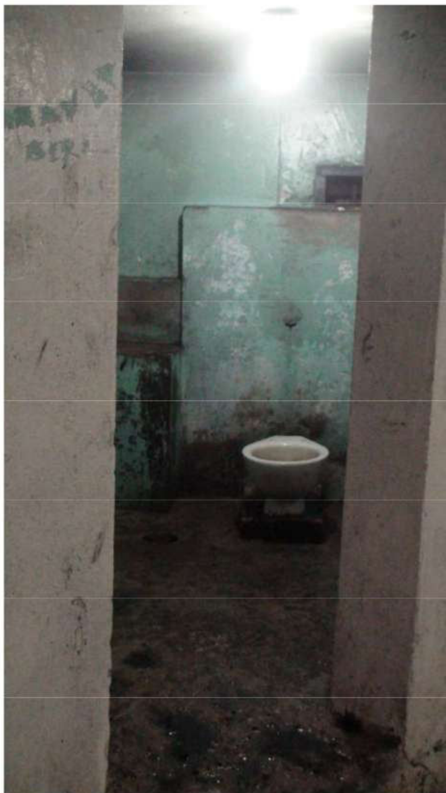
Área com vaso sanitário no interior do raio, usada pelas visitantes
