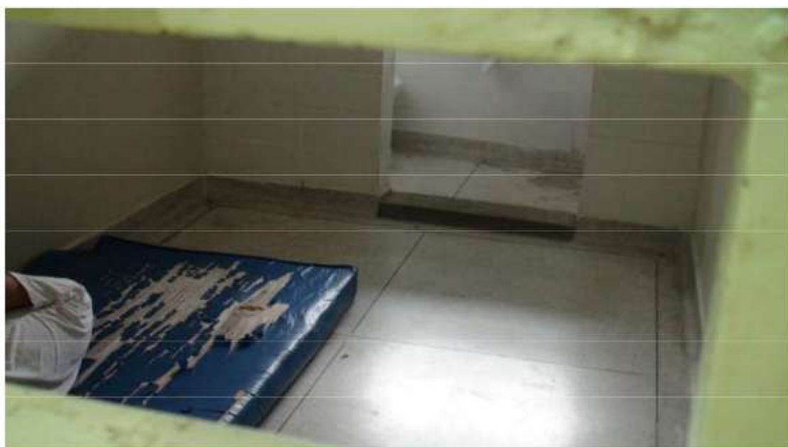
Cela ocupada, sem leito, colchão no chão
