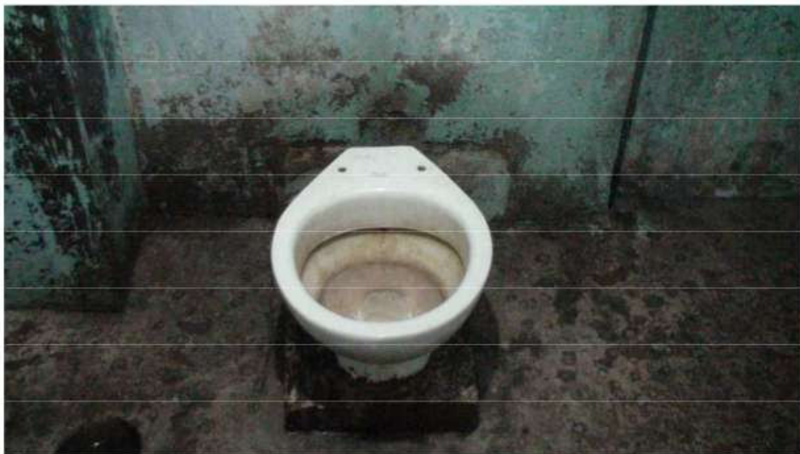
Vaso sanitário quebrado, para uso pelas visitantes
