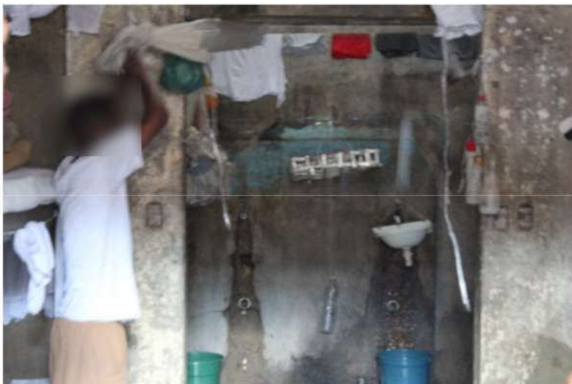
(pia danificada e ausência de pia)
