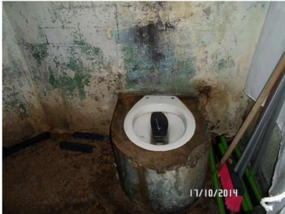
(Vaso sanitário de cela do setor de convívio)
