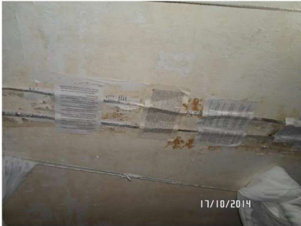
(Precárias instalações elétricas feitas com alumínio que acondiciona as refeições)
