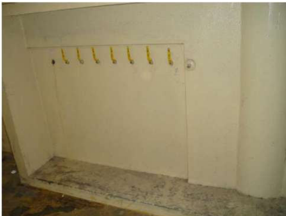
Registros de controle de água
