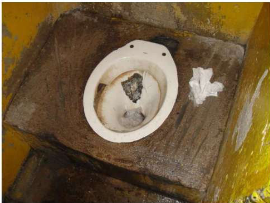
Vaso sanitário entupido
