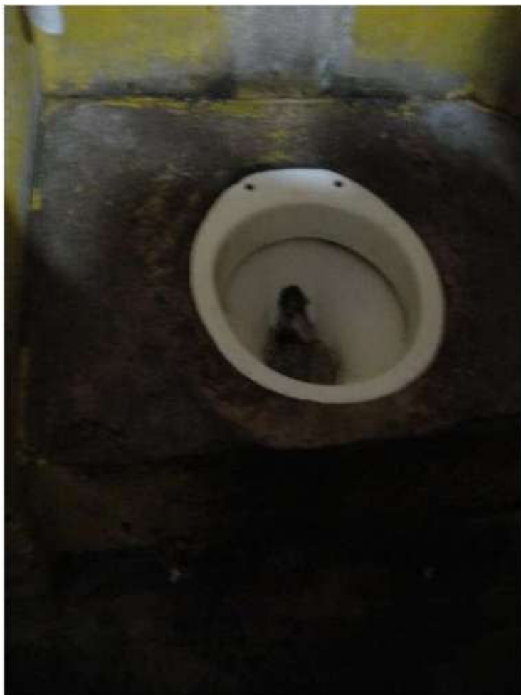
Vaso sanitário precário
