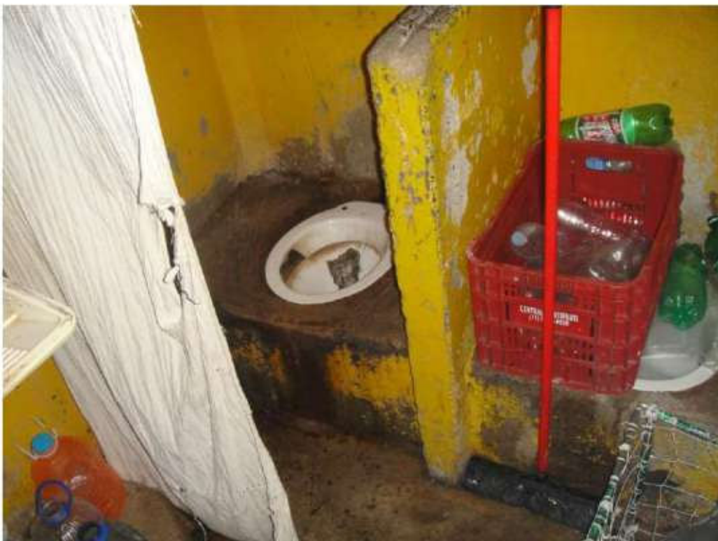
Estado precário da cela
