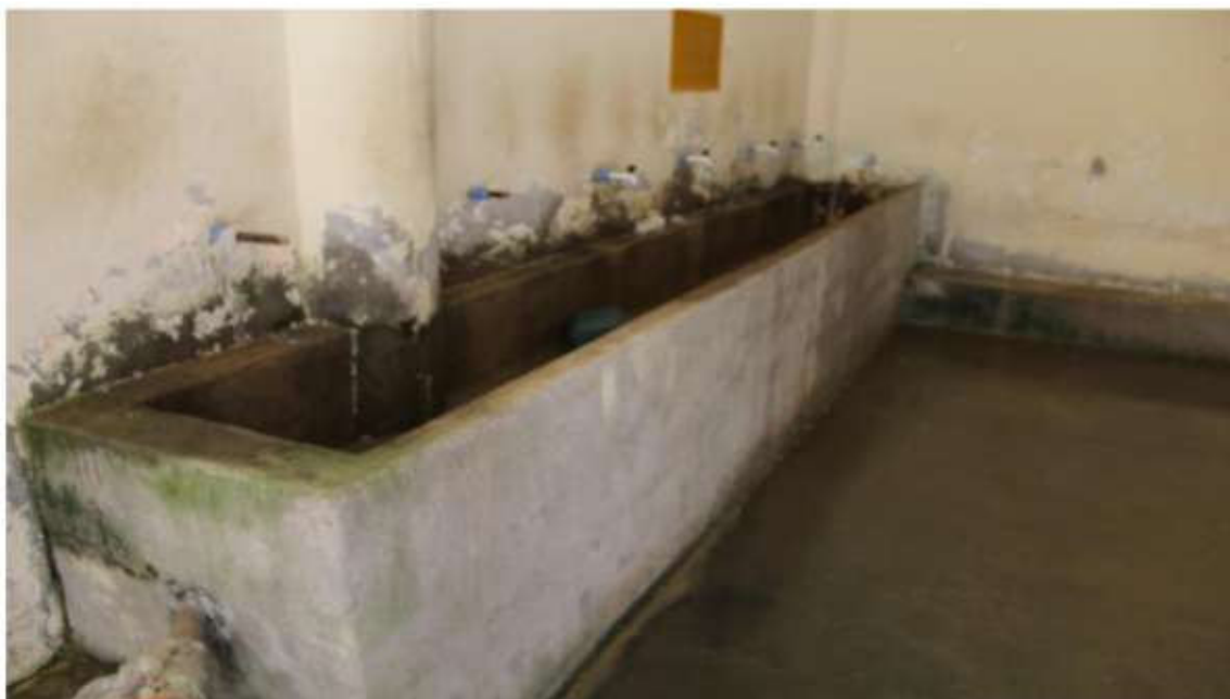
(tanque coletivo sem algumas torneiras)
