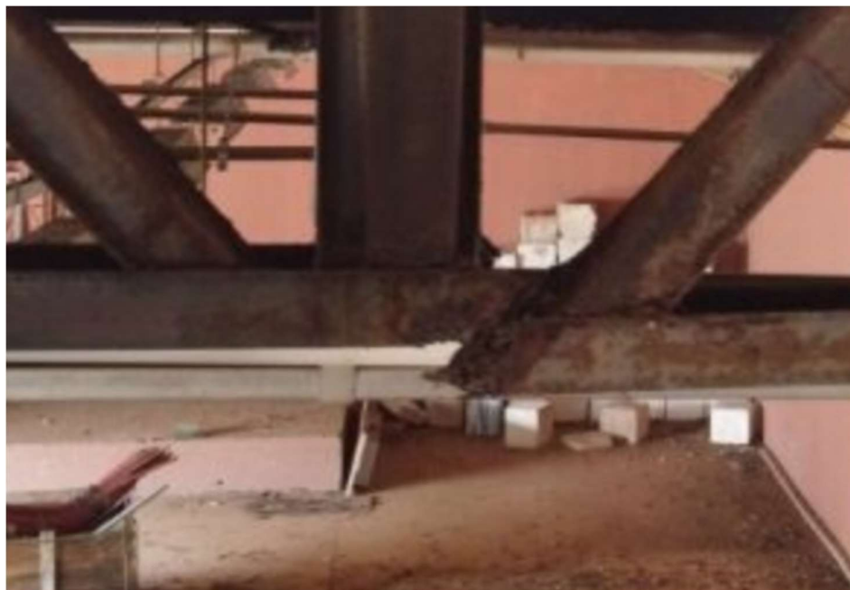
Foto 1: Patologia típica apresentada nas treliças. Fonte: equipe da regional local.
